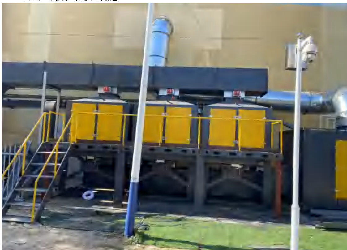
废气处理设施
