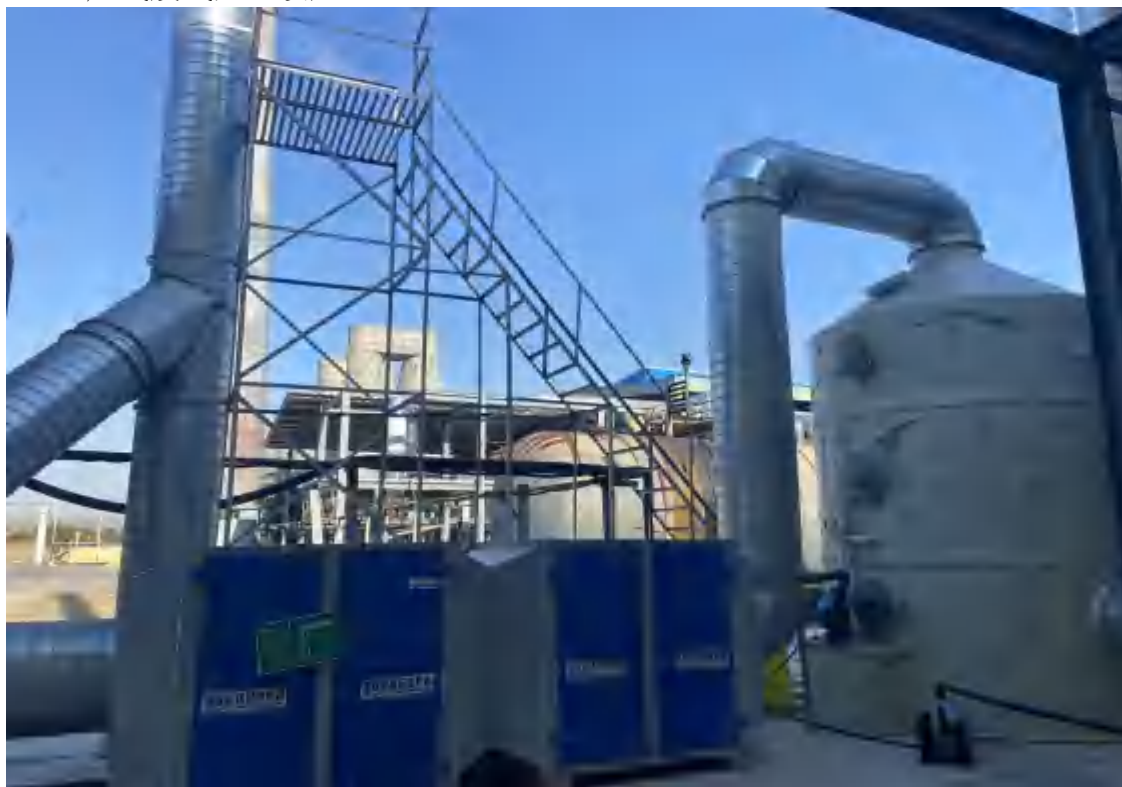
P1-P5 生产线废气处理设施
