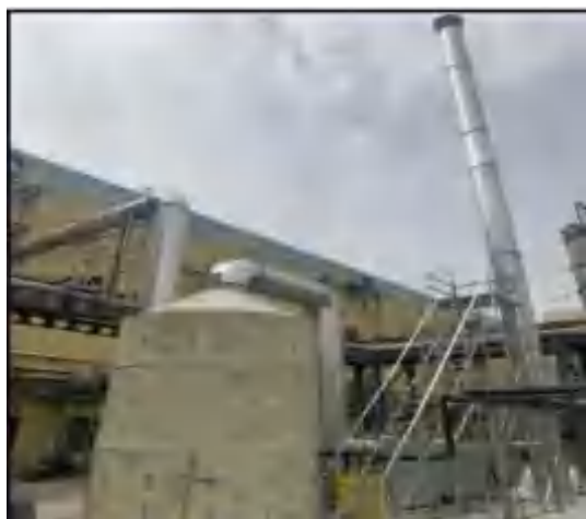
纵向拉伸薄膜生产、销售项目喷淋塔
