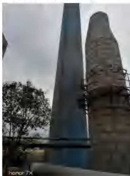
热媒炉处理装置及排气筒
