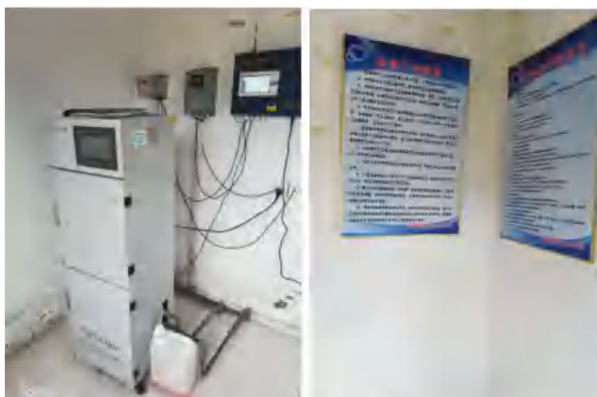
污水排放口在线监控设施
