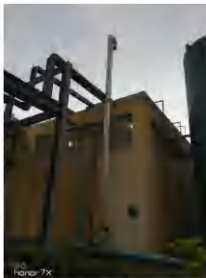
PTA 投料口处理设施及排气筒
