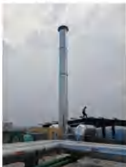
含尘废气排气筒
